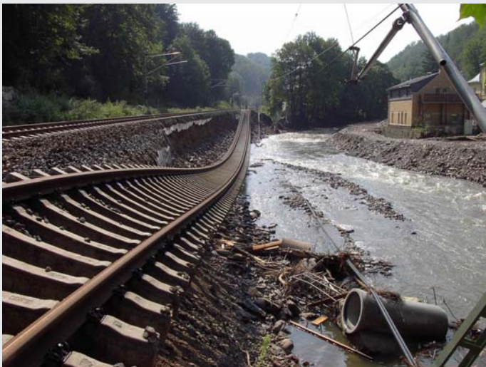
Hochwasserschaden im August 2003
